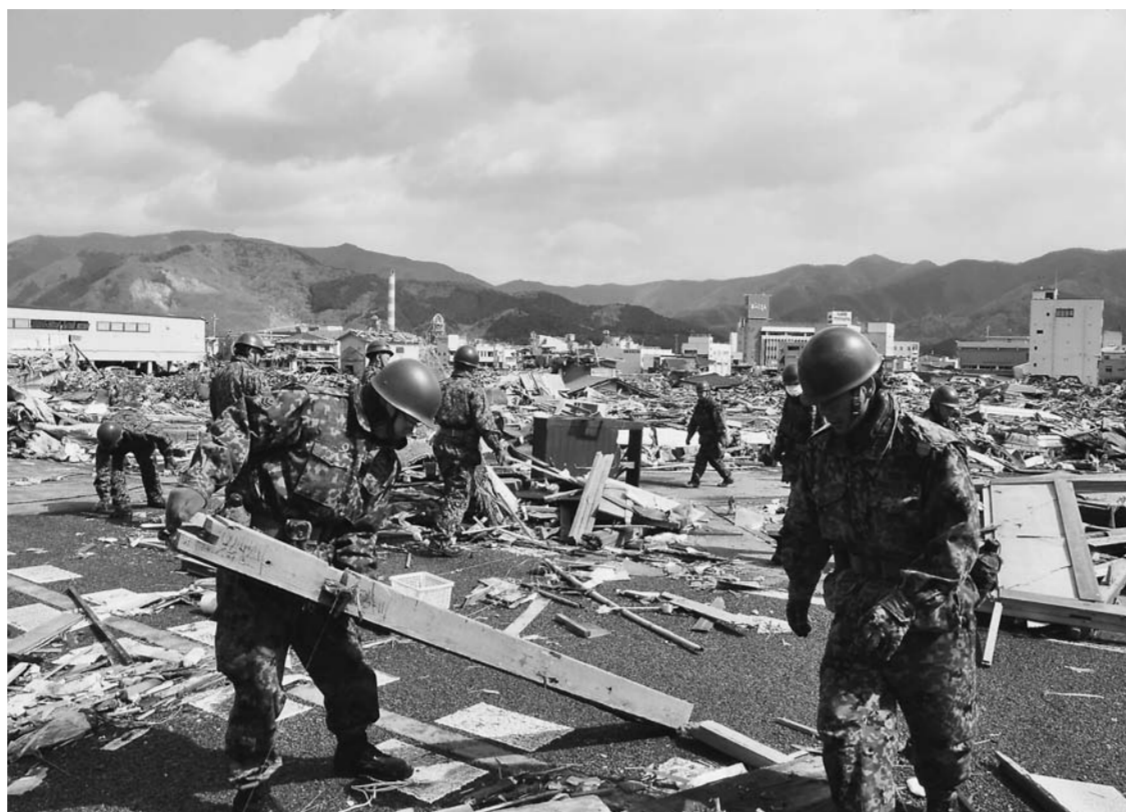
車両が通行できるよう国道45号のがれきを片付ける自衛隊員＝大船渡町
