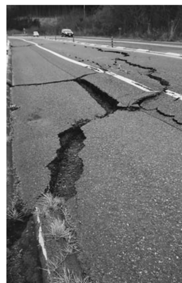
多くの道路で亀裂が発生。ひび割れが広がる可能性もあり、注意が必要＝立根町の三陸縦貫道
